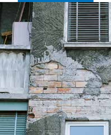
Huonokuntoinen, korjausta vaativa rakennuksen julkisivu
